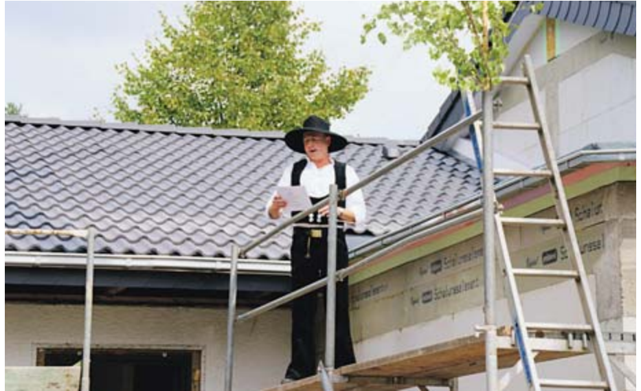
Günther Fell sprach in zünftiger Manier den Richtspruch für das neue Bürgerhaus.
